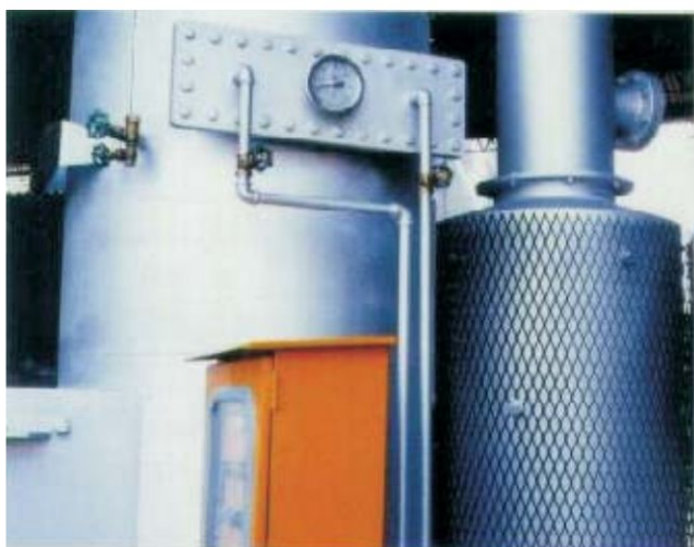
利用熱交換器，回收熱能的再次利用
